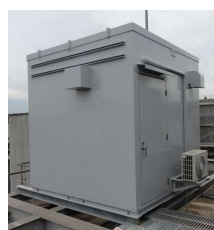
屋上キュービクル
